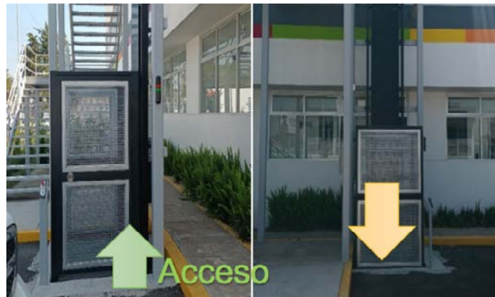
Figura 18 Montacargas exterior sin accesibilidad adecuada
