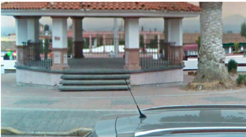
Imagen 5. Escaleras sin barandales ni rampas (González, 2022)
