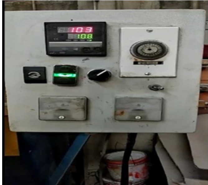
Figura 2. Tablero de control actual 2
