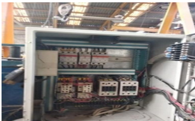
Figura 4. Elementos internos del tablero de control actual
