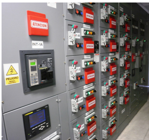
Figura 2. Cuarto de Control de Máquinas CCM
