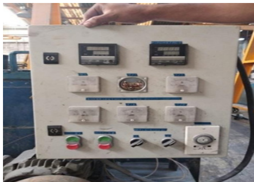
Figura 1. Tablero de control actual 1
