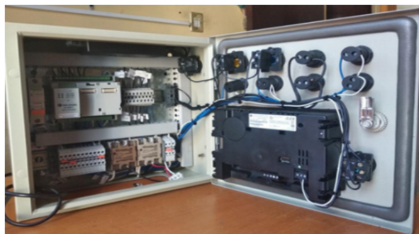
Figura 9. Gabinete de control con PLC
