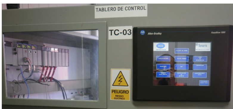
Figura 1. Tablero de control del PLC y la HMI
