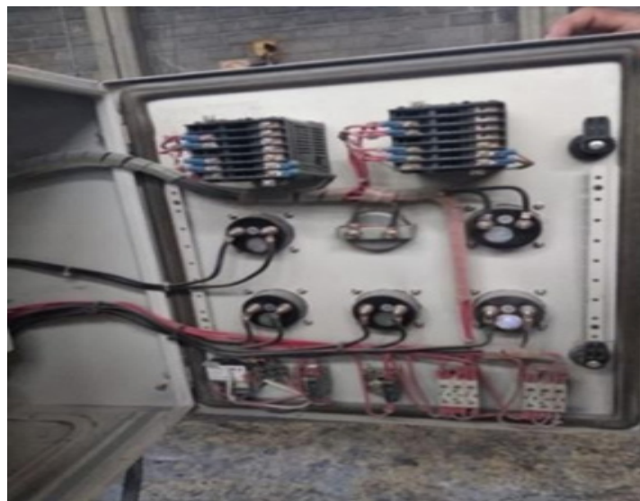
Figura 3. Cableado del tablero actual
