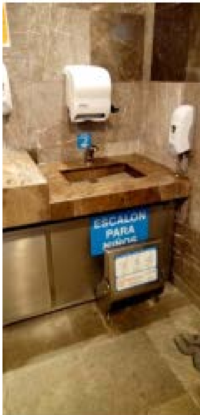
Imagen 7 Diseño realizado en un lavabo para niños, cuya altura podría funcionar para una silla de ruedas, pero la falta de espacio inferior para penetración de la silla imposibilita su uso para la discapacidad (Solano, 2018)
